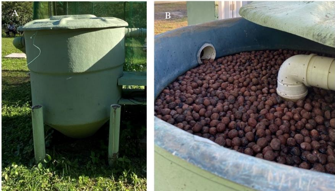
Figura 14 - Biofiltro Misto do EE: (A) Vista externa e (B) Vista por dentro com detalhe do meio filtrante (argila expandida).
