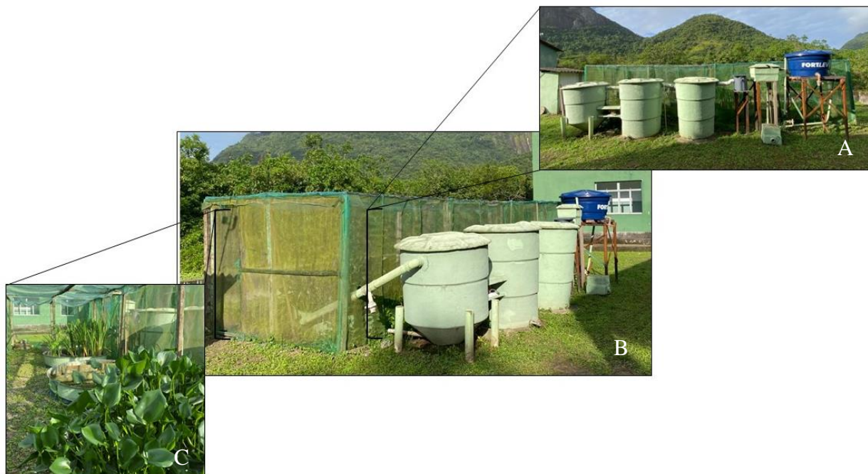
Figura 7 - Fotografias do Ecossistema Engenheirado: (A) tratamento convencional, (B) Vista frontal do sistema e (C) Tratamento ecológico.
