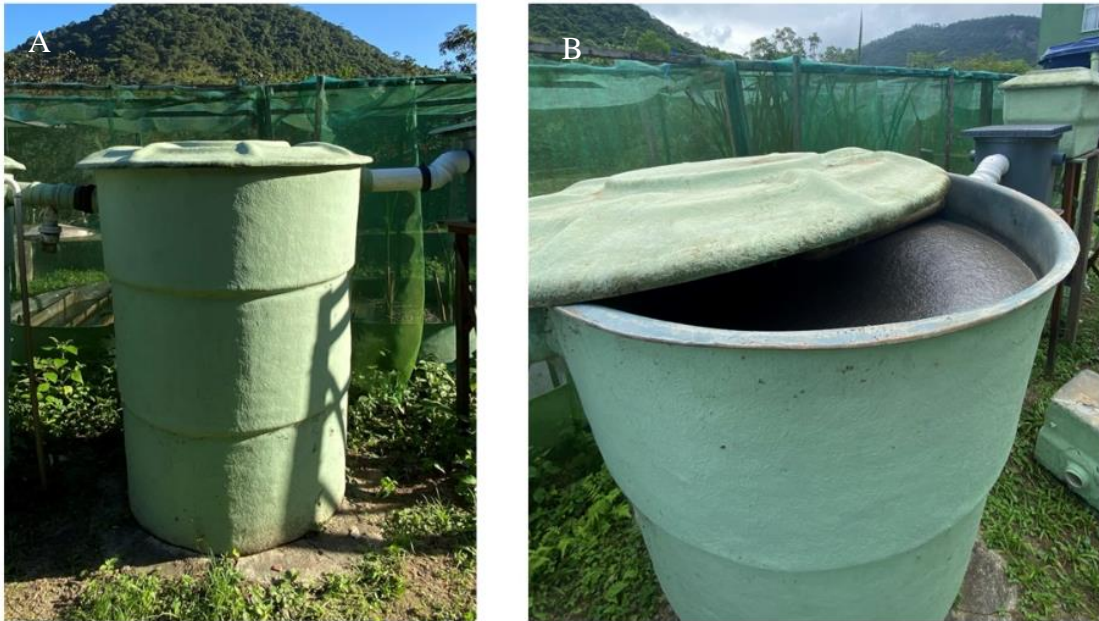
Figura 10 - Tanque Séptico do EE: (A) Vista externa e (B) Vista por dentro com detalhe para espuma na camada superior do tanque.
