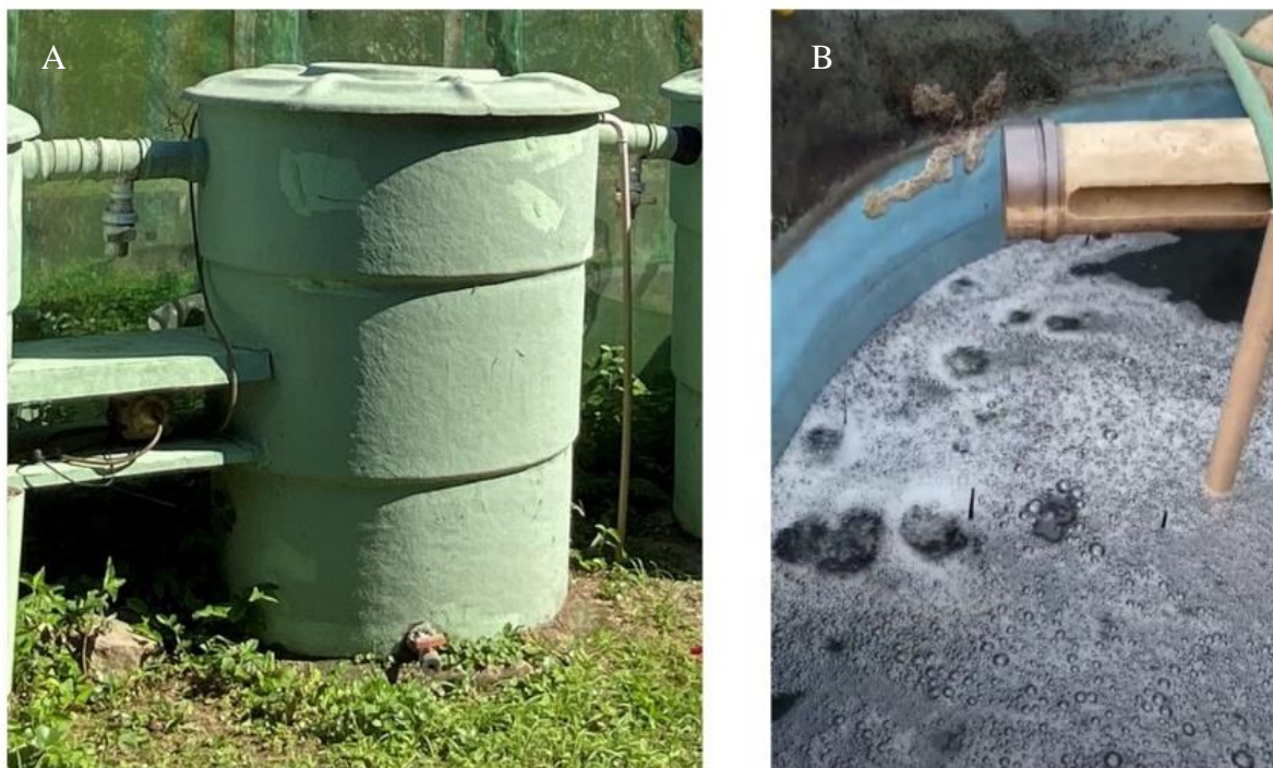
Figura 13 - Filtro Aerado Submerso do EE: (A) Vista externa com a bomba de ar e (B) Vista por dentro com detalhe da formação das bolhas de ar.
