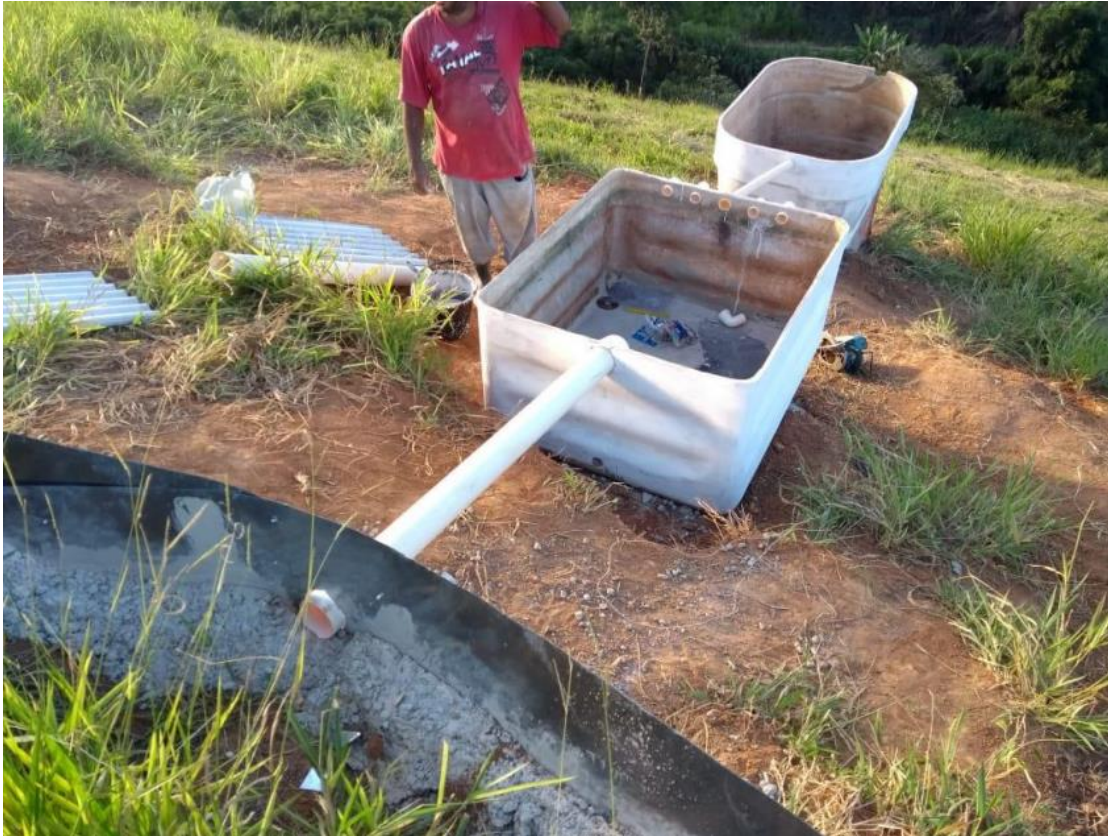
Figura 25 – Sistema de conexão entre o corpo das parcelas e as caixas d'água.
