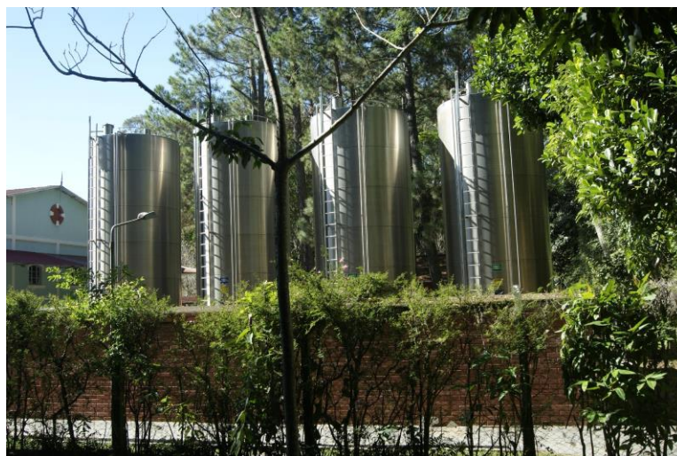
Figura 26 – Reservatórios no Parque de Caxambu
