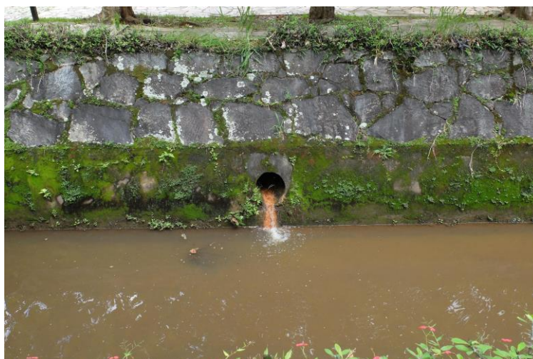
Figura 18 – Desague no ribeirão Bengo
