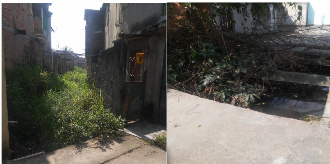
Figuras 20 e 21 - Rio receptor de esgotamento domiciliar e galeria aberta receptora de águas pluviais e esgoto – Rua Bernardo Sayão
