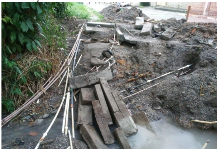
Figura 49 - Ligações clandestinas de água - distrito de Monjolo
