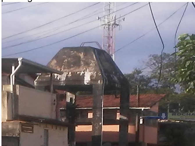
Figura 30 - Caixa d'água comunitária inabilitada pela Águas do Rio
