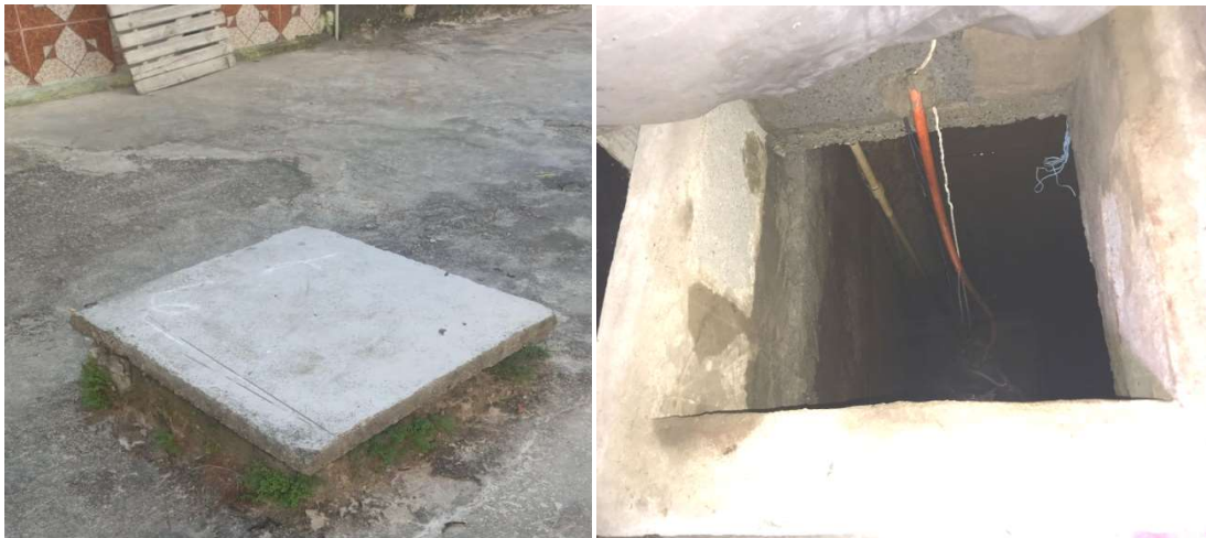
Figuras 50 e 51 - Cisterna domiciliar e vista interna de cisterna com bomba hidráulica submersa – bairro Jardim Catarina
