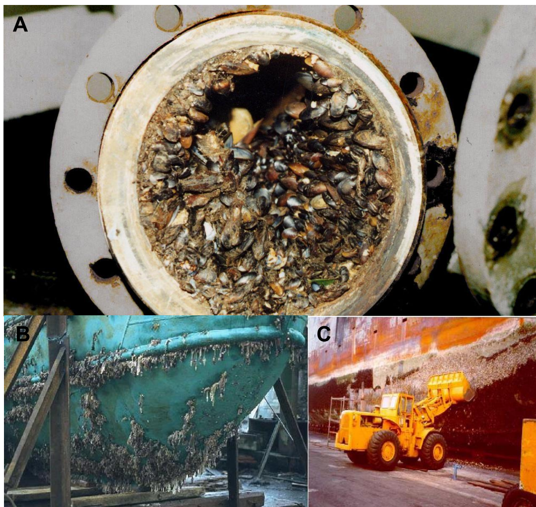
Figura 2 – Estruturas prejudicadas pela bioincrustação.
