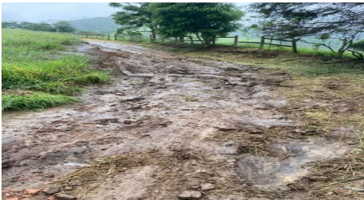
Figura 27 – Chuvas de janeiro 2022 provocaram problemas de drenagem nas estradas vicinais
