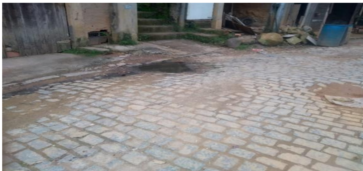
Figura 13 – Esgoto a céu aberto na comunidade é reclamação constante
