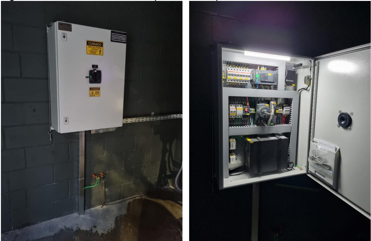
Figura 12 – Painel elétrico dos componentes complementares do SMO.
