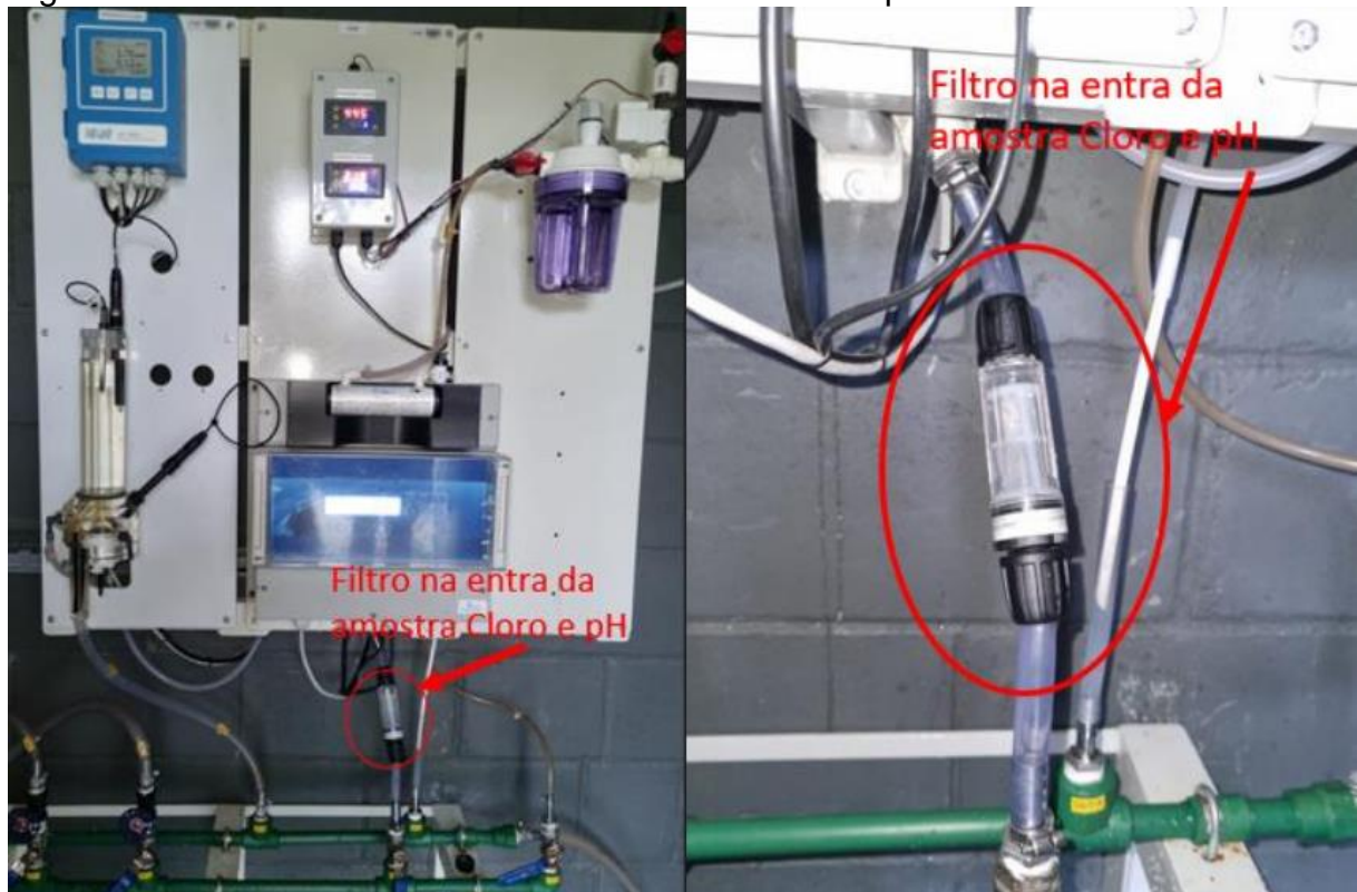
Figura 16 – Filtro instalado nos módulos de análise de pH e cloro.
