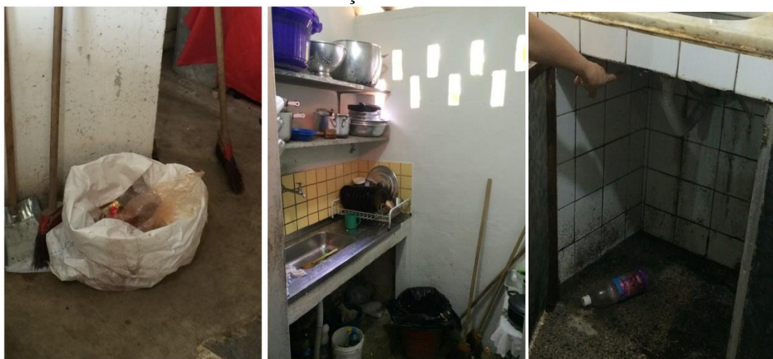
Figura 20 - Armazenamento de resíduos indevido e esgoto exposto - EM Francisca Jeremias e EM Aline Gonçalves de Lima
