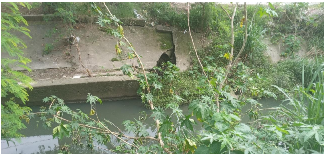
Figura 34: Tubulação destruída no rio Campinho
