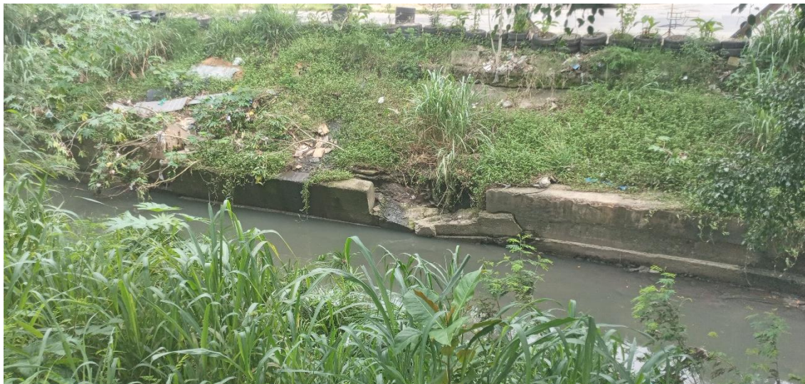
Figura 36: Trecho de margem destruída do rio canalizado
