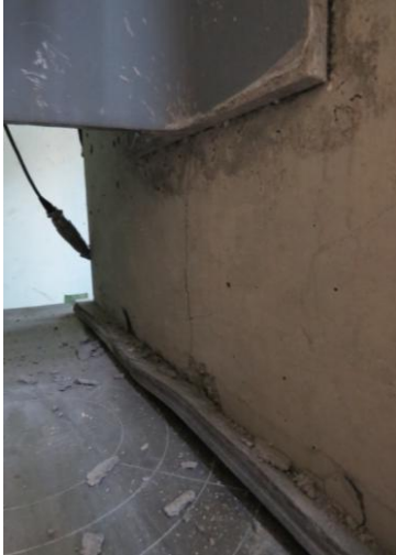
a) Fissura inicial de cisalhamento do TP C25/30
