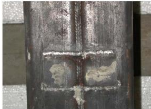
c) Ruptura da solda
