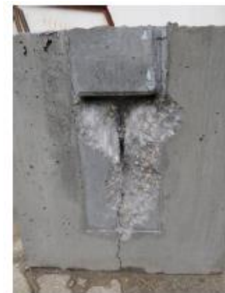
Figura 29 – Esmagamento do concreto do conector TP C25/30 (PESSOA, 2015)
