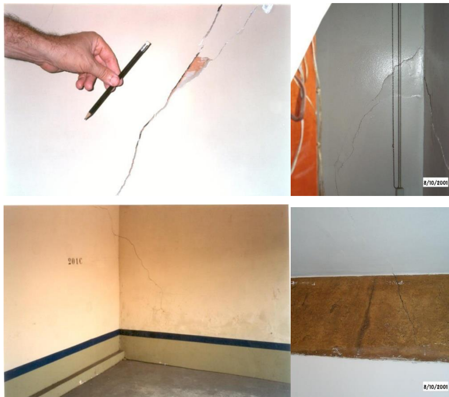
Figura 31. Fissuras nos apartamentos, Rosa (2005)
