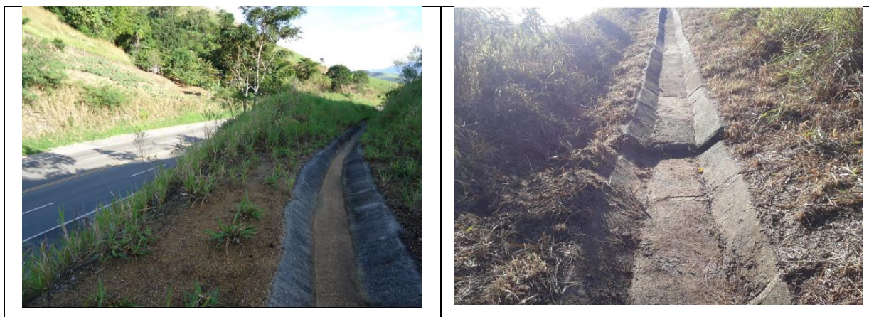
Figura 21a e 21b – Trincas em canaletas fotografadas em 2012 e 2020
