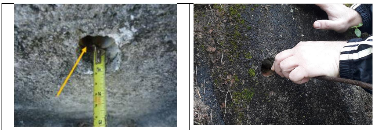
Figura 22a e 22b – Movimentações de DHP em relação a base do talude fotografadas em 2012 e 2020
