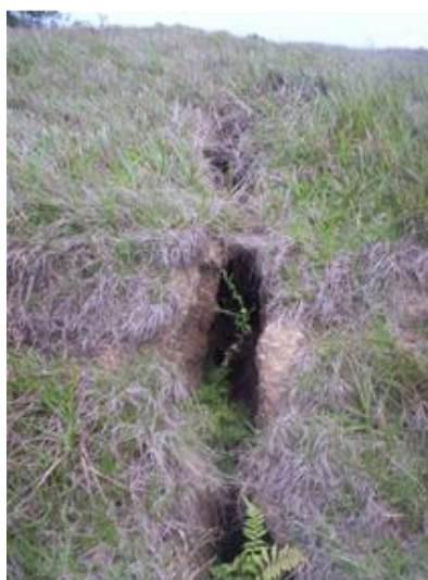
Figura 15 – Evidências de movimentação no talude (CCR. 2005)
