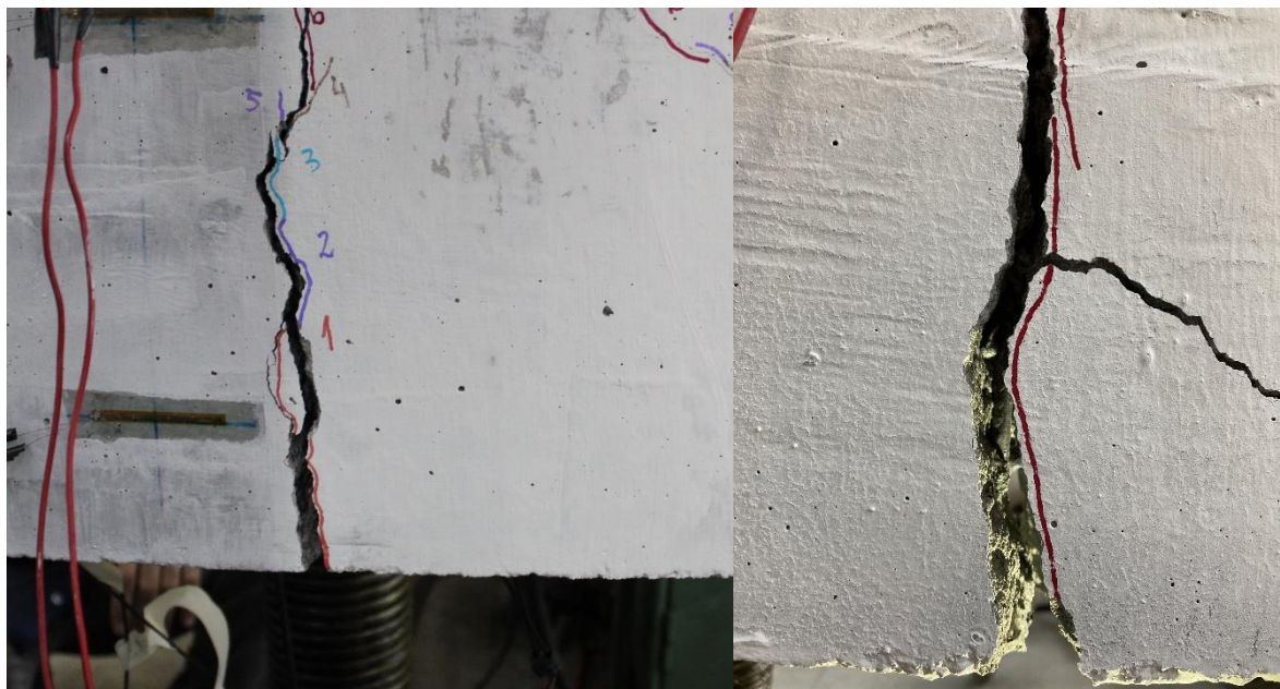
Figura 87 - Imagem aproximada da viga 1, a esquerda e viga 2, a direita, após a ruptura por flexão
