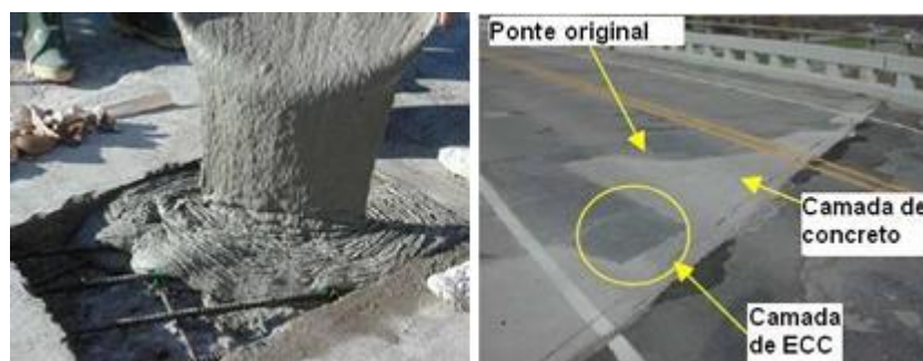
Figura 3 - Reparo do tabuleiro de uma ponte em Michigan, Estados Unidos, utilizando ECC (LI, 2004).
