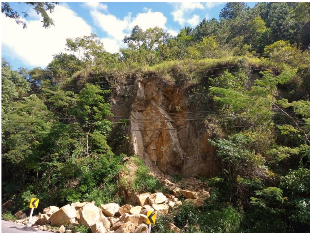
Figura 5 – Exemplo de Queda de Blocos no maciço rochoso gnáissico, localizado na Rodovia Dr. Rogério Moura Estevão, RJ-130, Km 18,5, Bairro Venda Nova – RJ, que atingiu um dos sentidos da rodovia (Fotografia: Samara Santos, tirada em abril de 2023).
