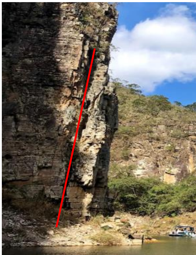
Figura 13 – Ruptura por Tombamento (G1, 2022).
