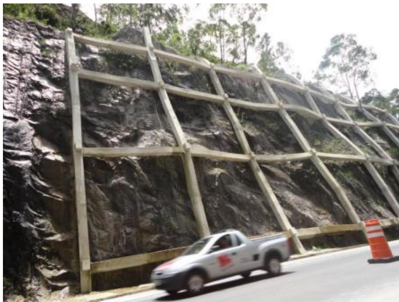
Figura 23 – Grelhas ancoradas em encosta rochosa na rodovia BR-040 em Petrópolis-RJ (Freitas, 2013).
