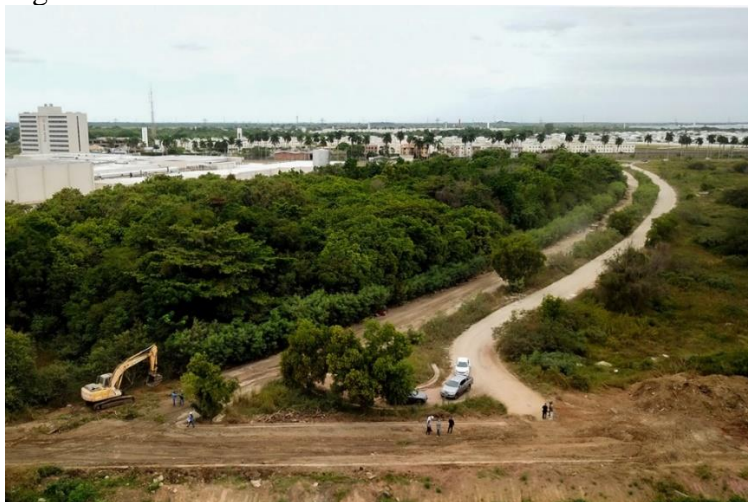
Figura 28 – Parceria Público-Privada com abertura de rua no trecho da Estrada do Contorno
