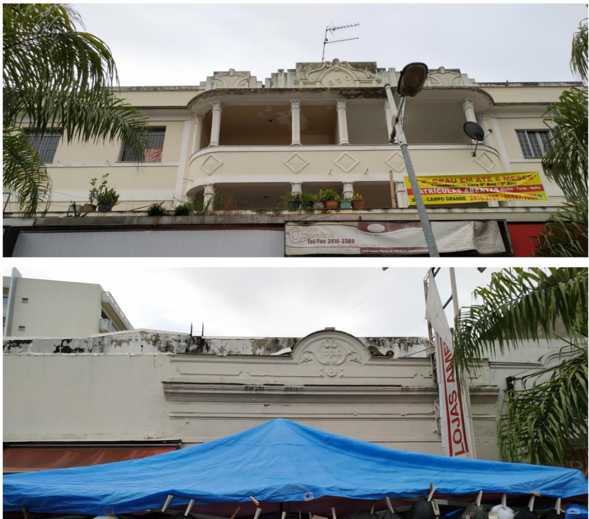
Figura 14 - Casario refuncionalizado na Rua Barcelos Domingos, Campo Grande – Rio de Janeiro em 2019.
