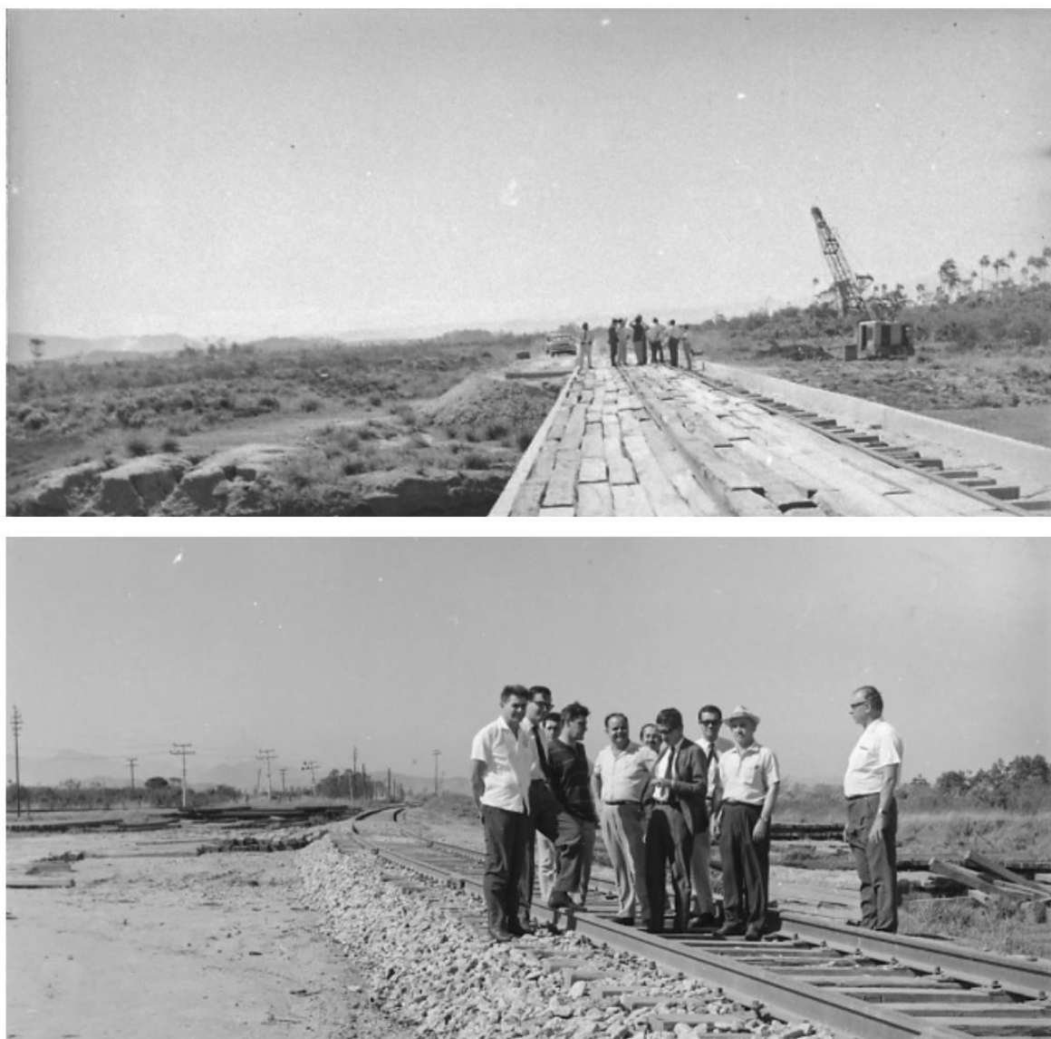
Figura 38 - Membros da Associação Comercial e Industrial de Campo Grande (ACICG) visitam as obras do terminal marítimo de Santa Cruz, Rio de Janeiro, GB em 23 de junho de 1967.
