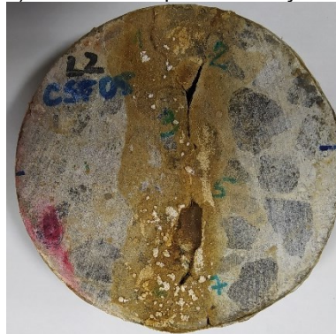
e) L2 – 30 dias após a fissuração
