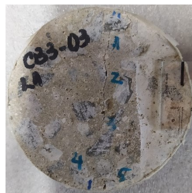
c) L1 – 60 dias após a fissuração
