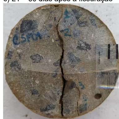
f) L2 – 60 dias após a fissuração
