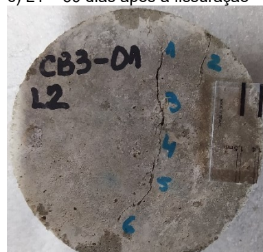
f) L2 – 60 dias após a fissuração
