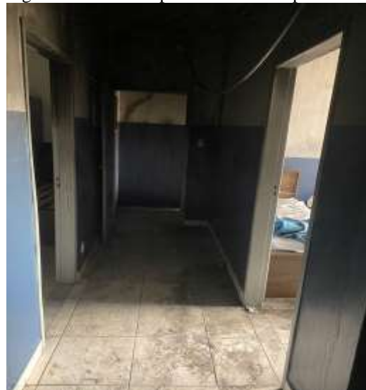
Figura 41 - Parte superior do CAPS após o incêndio
