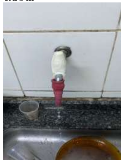
Figura 27 - Remendo na torneira do CAPS III
