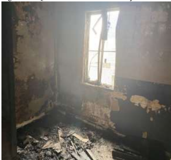
Figura 40 - Quarto onde o incêndio começou
