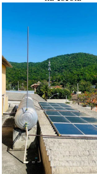
Figura 7 - Placas solares e boilers instalados na escola
