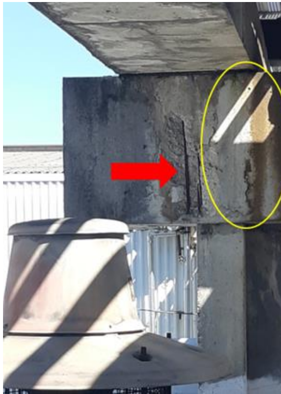
Figura 4 – Estrutura de concreto deteriorada com o tempo
