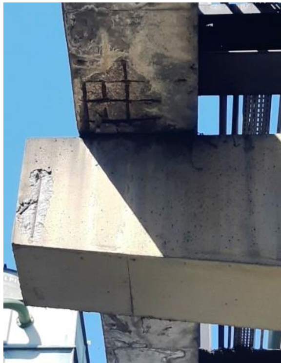
Figura 3 – Estrutura de concreto deteriorada com o tempo
