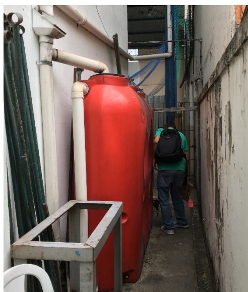
Figura 9 - Tanque de armazenamento de água da chuva utilizado pela equipe do laboratório de água da chuva, no colégio de Aplicação da UERJ, bairro da Tijuca, Rio de Janeiro, RJ.
