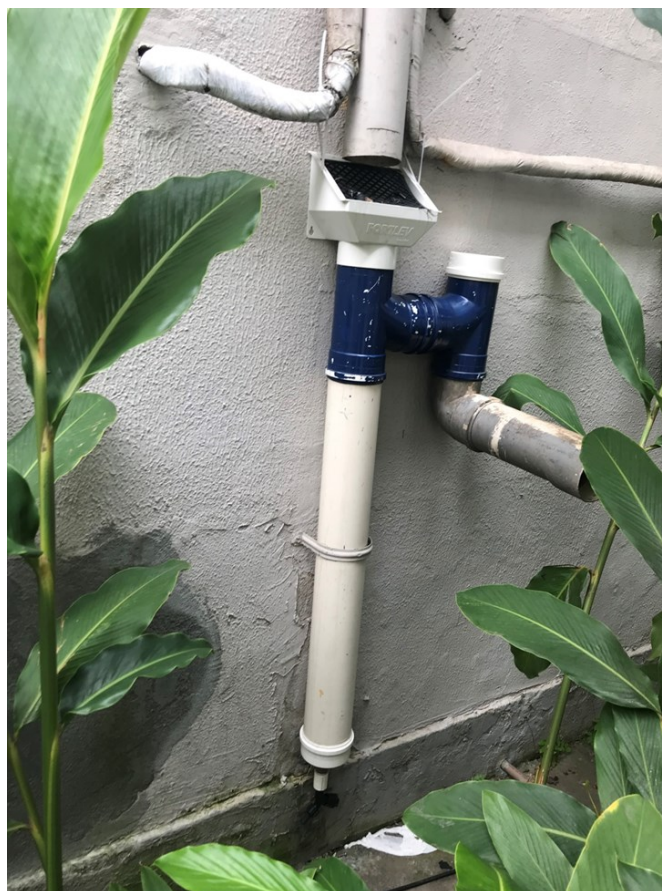
Figura 30 - Sistema de coleta da primeira água do escoamento superficial, First Flush, instalado no tubo de drenagem do telhado e da laje do andar superior, Colégio Eliezer Max, Laranjeiras, Rio de Janeiro.
