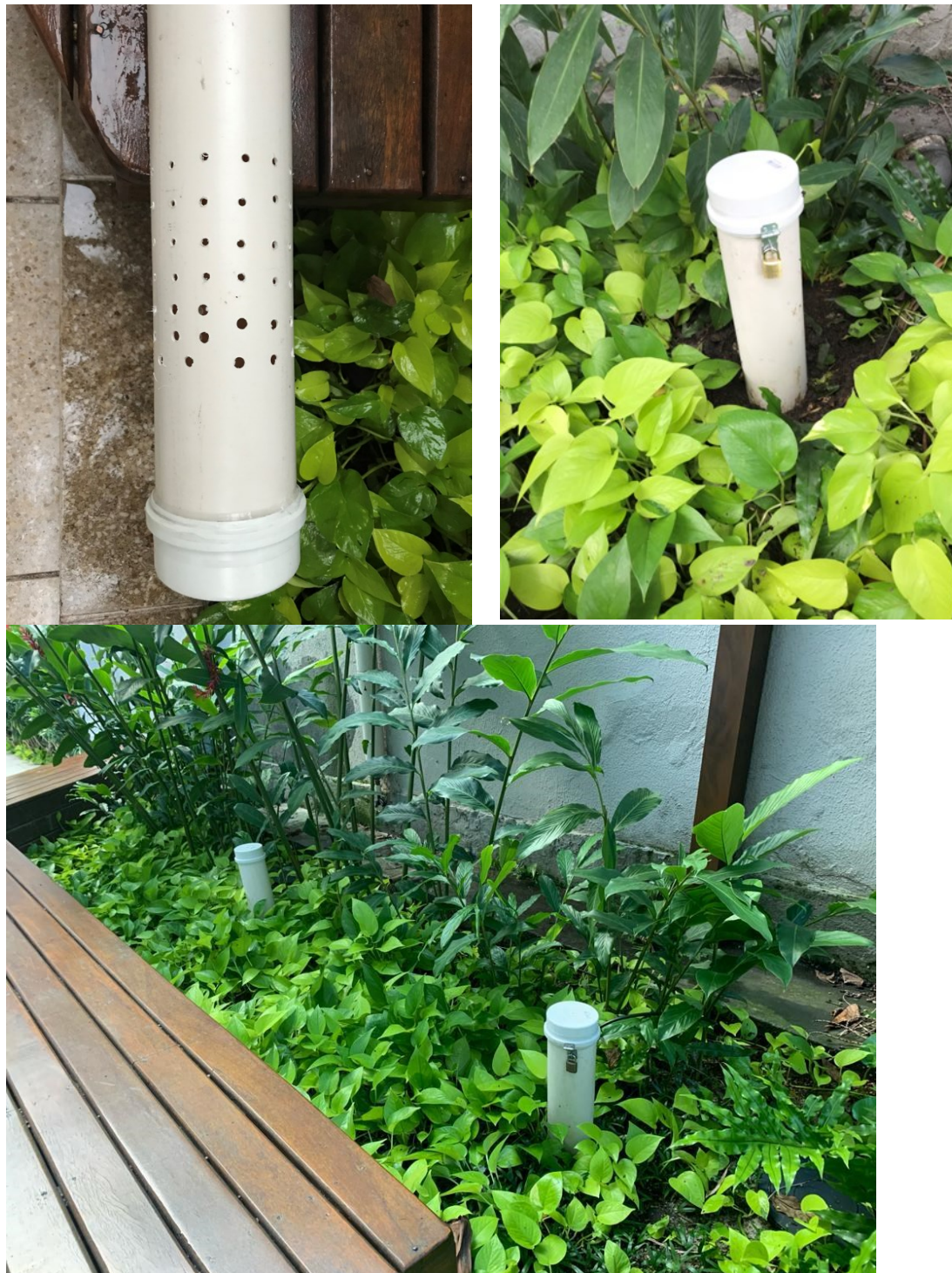
Figura 31 - Tubo instalado no jardim de chuva para coleta da água após a passagem pelo jardim.
