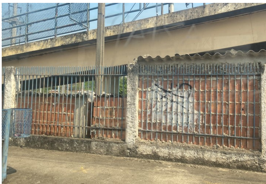
Figura 46 - Grades Estação de Costa Barros
