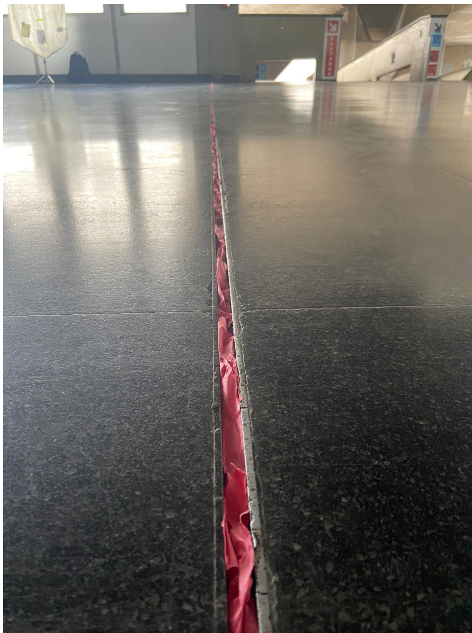
Figura 20: Intervenção artística na rachadura Fonte: Acervo da pesquisadora. Foto por Sulamita Freire.
