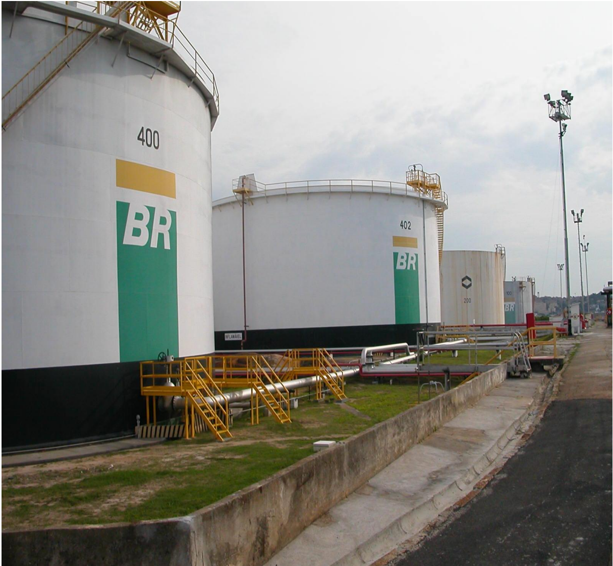
Fotografia 8 - Tanques cilíndricos da ID
