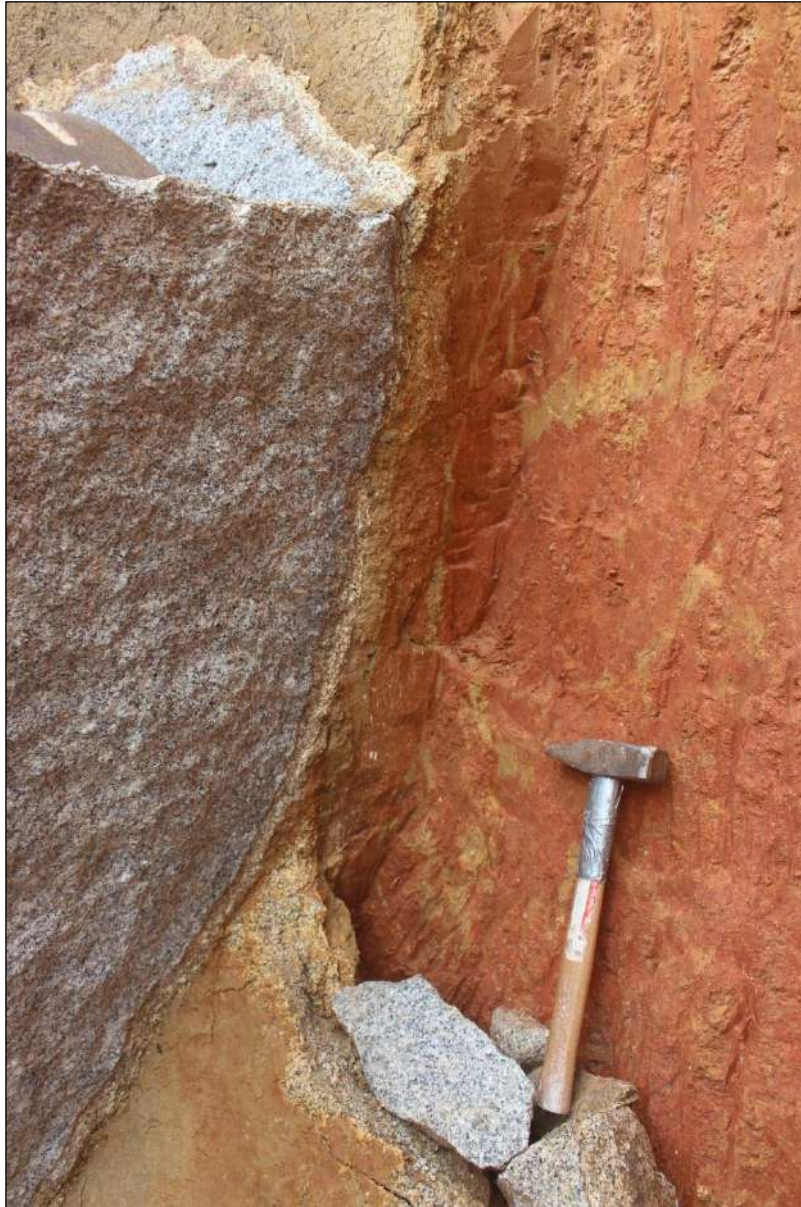
Figura 42 - Lâminas de alteração do matacão granítico
