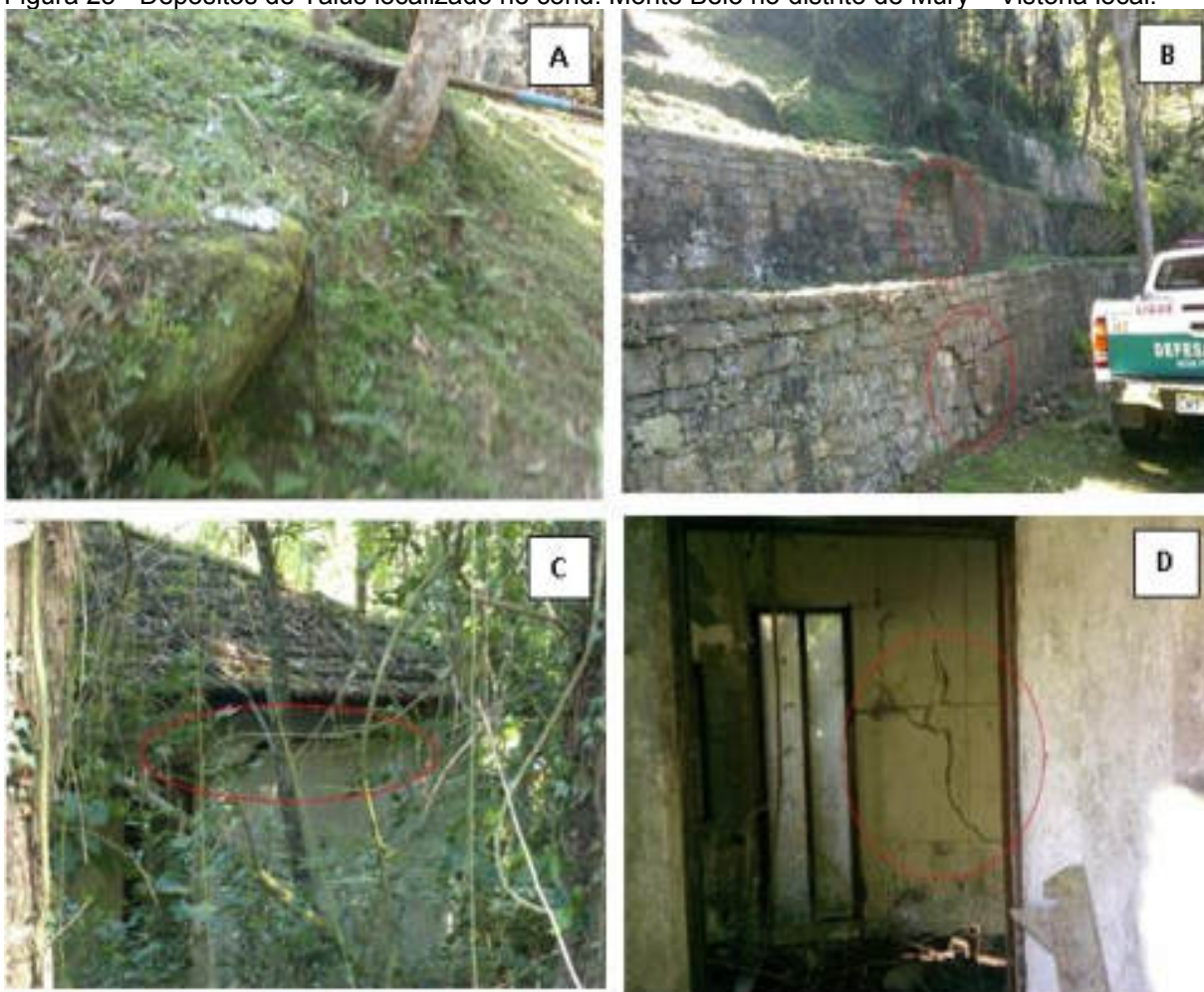
Figura 25 - Depósitos de Tálus localizado no cond. Monte Belo no distrito de Mury – Vistoria local.
