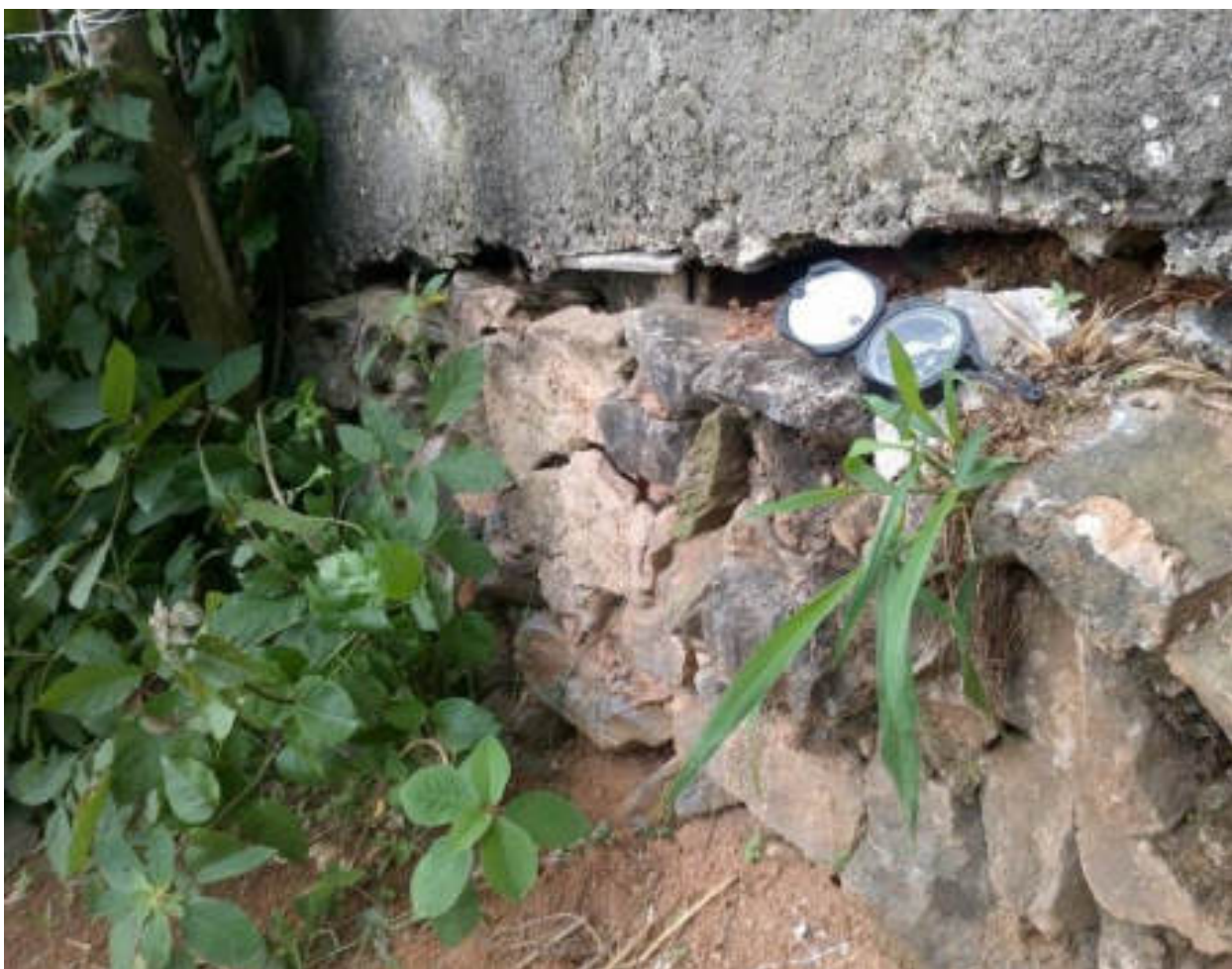
Figura 52 - Recalques na construção – Vistoria local
