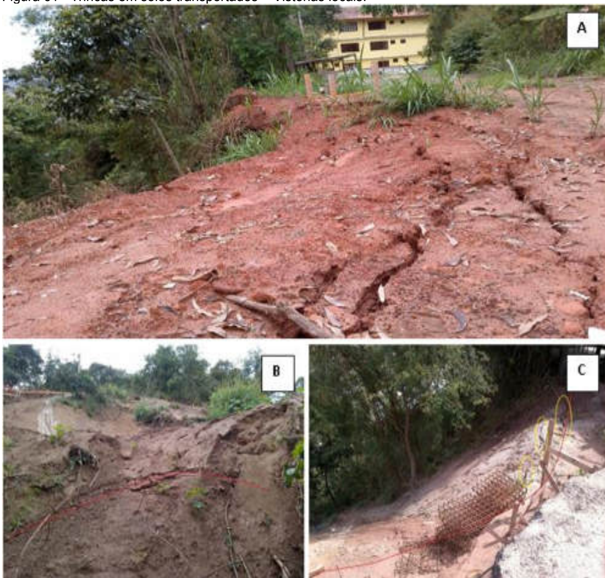
Figura 61 - Trincas em solos transportados – Vistorias locais.
