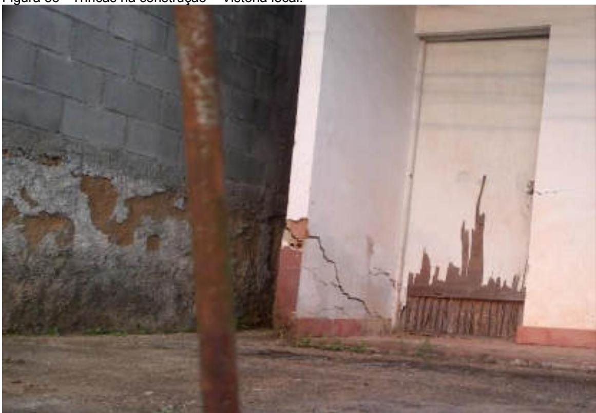
Figura 53 - Trincas na construção – Vistoria local.
