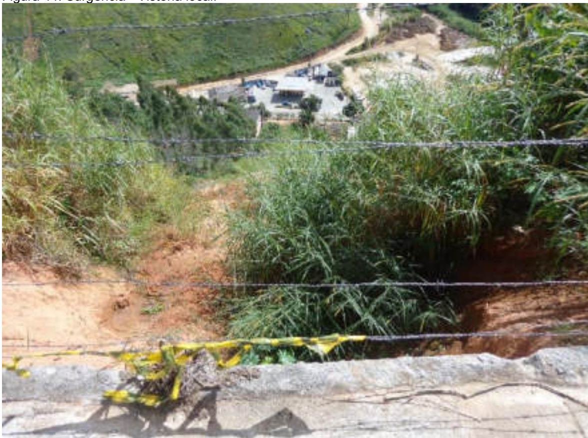
Figura 44: Surgência - Vistoria local.
