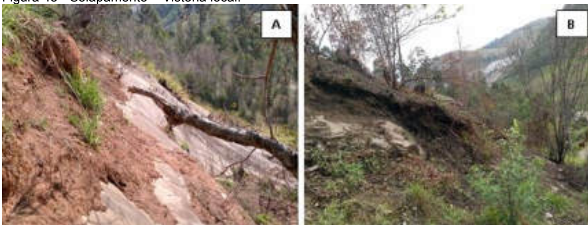
Figura 43 - Solapamento – Vistoria local.
