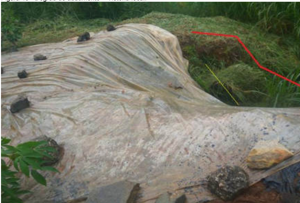
Figura 48 - Degrau de abatimento – Vistoria local.
