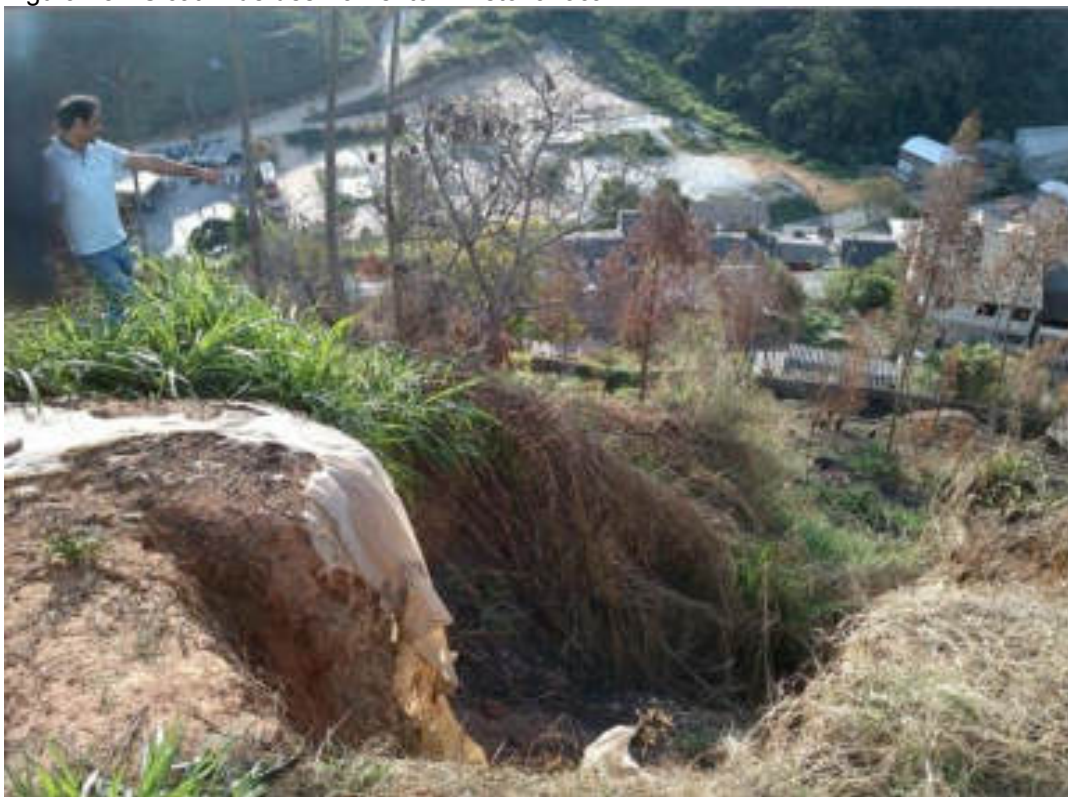
Figura 45 - Cicatriz de deslizamento – Vistoria local.
