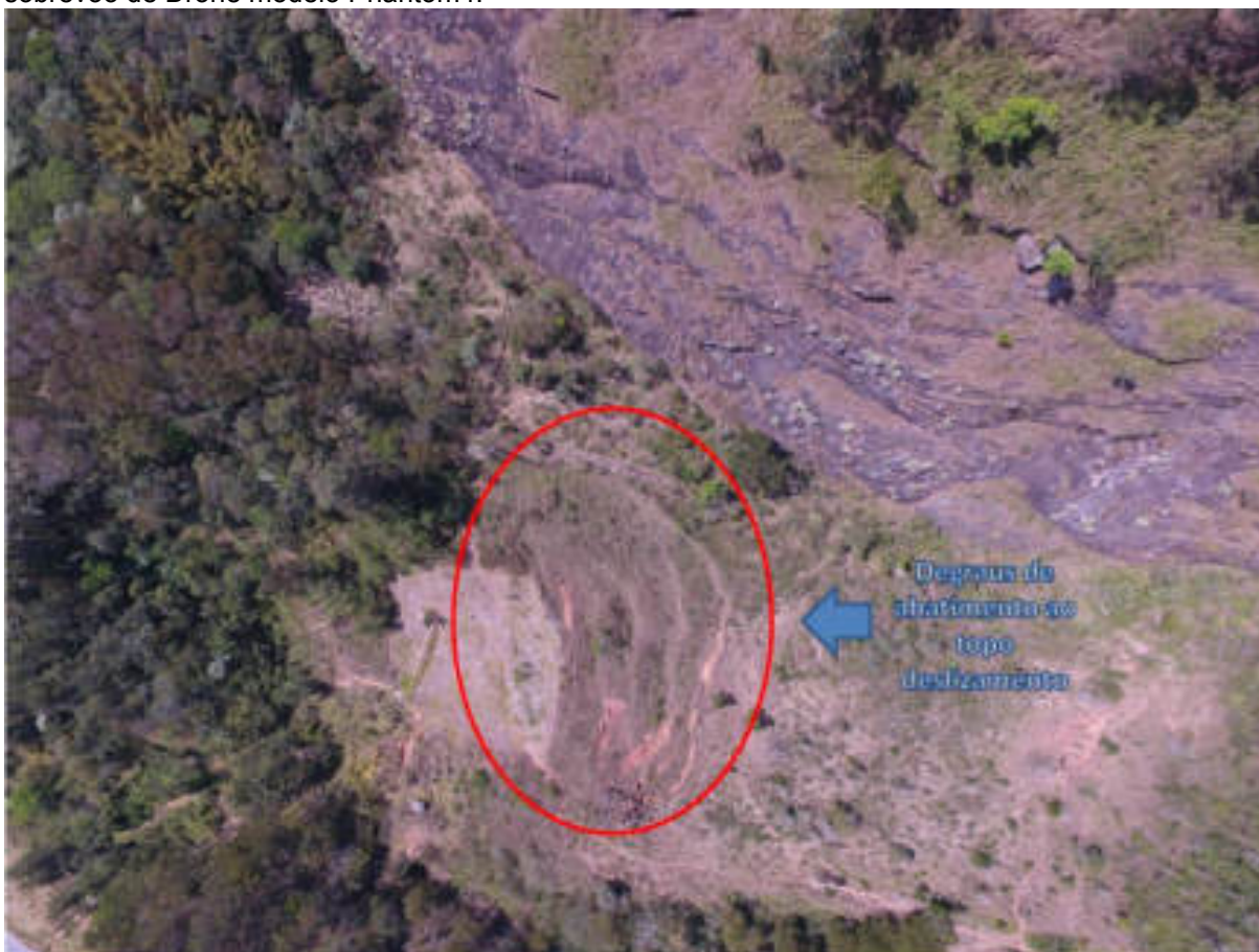
Figura 70 - Deslizamento rotacional ocorrido no bairro Ypú, distrito Sede – Vistoria local com sobrevoo de Drone modelo Phantom4.
