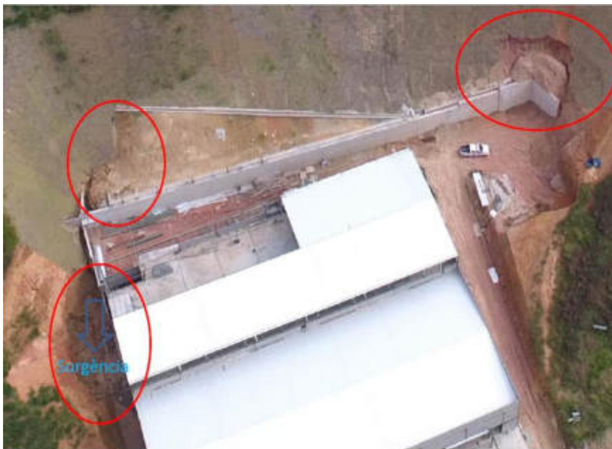
Figura 63 - Ruptura em solo residual e instabilidade geotécnica por surgência.
