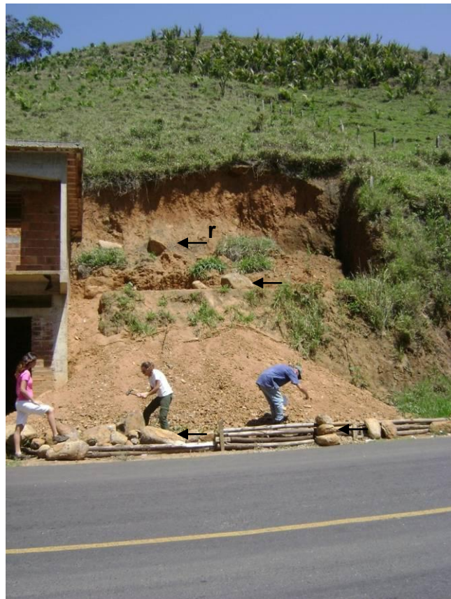
Figura 7 - Blocos de diabásio rolados ( setas ) em meio ao regolito ( r ) de cor ocre na região de Mangaratiba. Visada para NW. Ponto: MA-NF-02.
