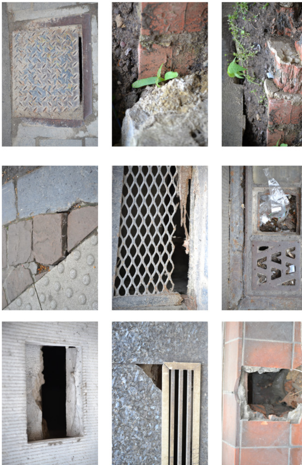
Figura 26 - Registro de fraturas
