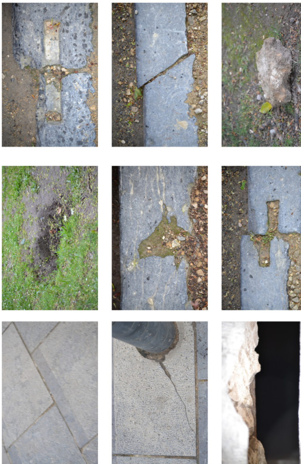
Figura 27 - Registros de fraturas
