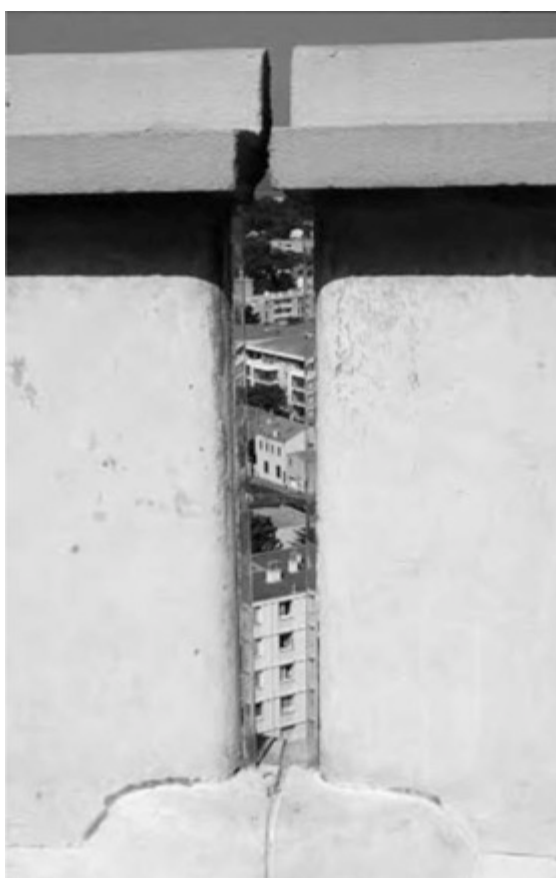
Fig. 79: Detalhe da junta de expansão do parapeito projetado por Le Corbusier. Fonte: SAMUEL, 2007, p. 2.
