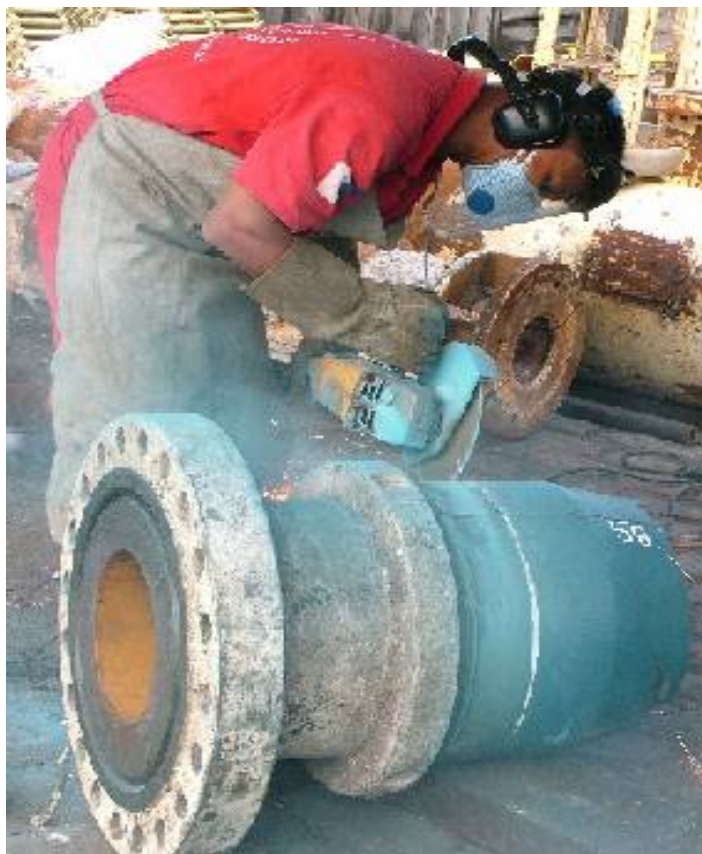
Figura 3.4: Corte da jaqueta e do preenchimento da resina epóxi (Petrobras)
