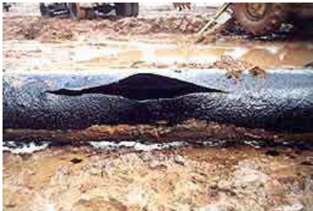
Figura 20 – Oleoduto rompido por corrosão
