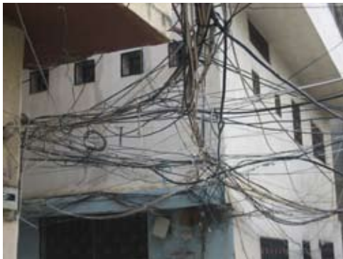
Figure 7: Détail des fils électriques, camp de Beddawi.
