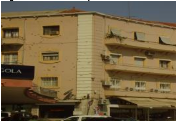
Figura 10 - Tiros nas paredes
