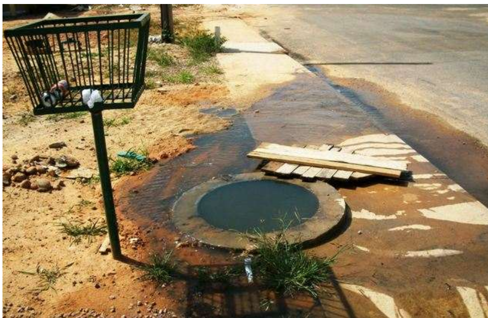
Foto 11: Esgoto transbordando em Nova Mutum-Paraná. Fonte: http://www.rondoniao vivo.com/noticias/caerd-moradores-de-nova-mutum-reclamam-de-sistema-de-esgoto-fotos-e-video/77839#.VLFavSvF-P8 . Acesso em: 05 nov. 2014.
