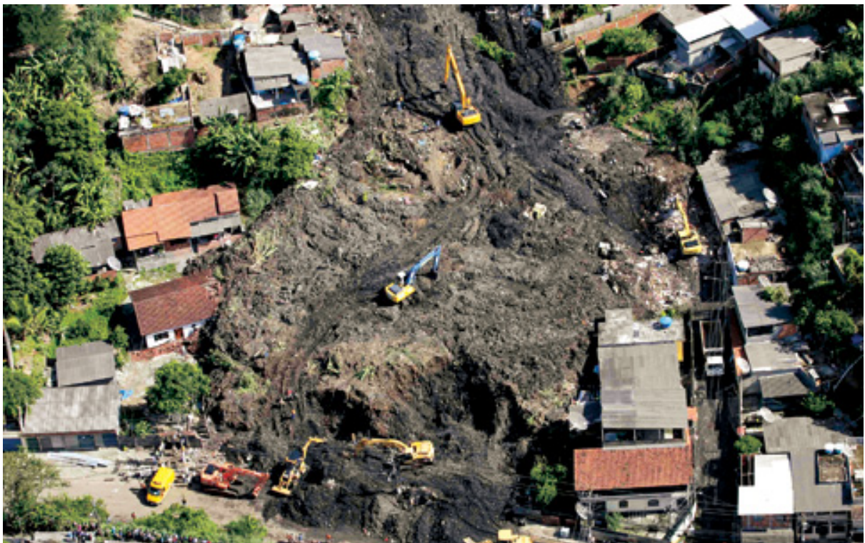
Figura 19 - Deslizamento do morro do Bumba
